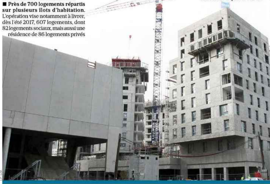
Massy, vendredi. Outre un cinéma de 9 salles (à gauche), le futur quartier Atlantis Grand Ouest sera notamment composé de près de 700 logements.
