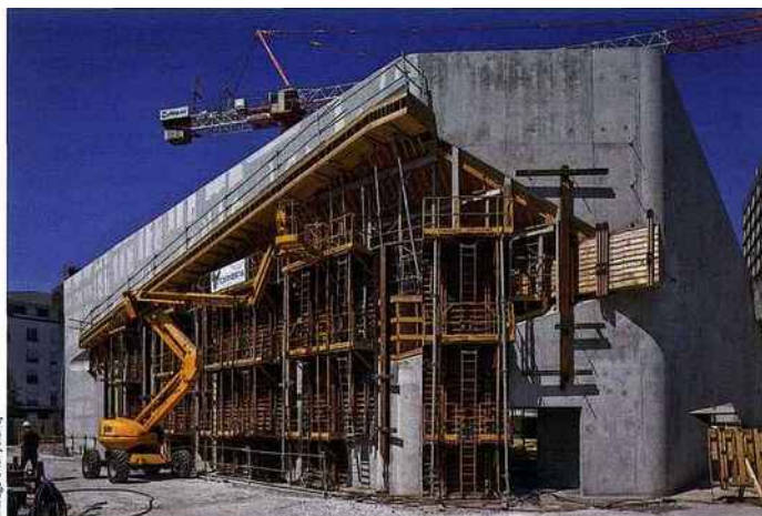
Le coffrage du pli de la façade Sud a été construit par l'entreprise Tournebois.
